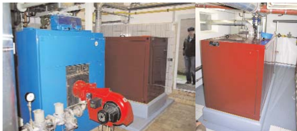
Heizungsanlage (blau) und BHKW (rot) der Stadtwerke Torgau
